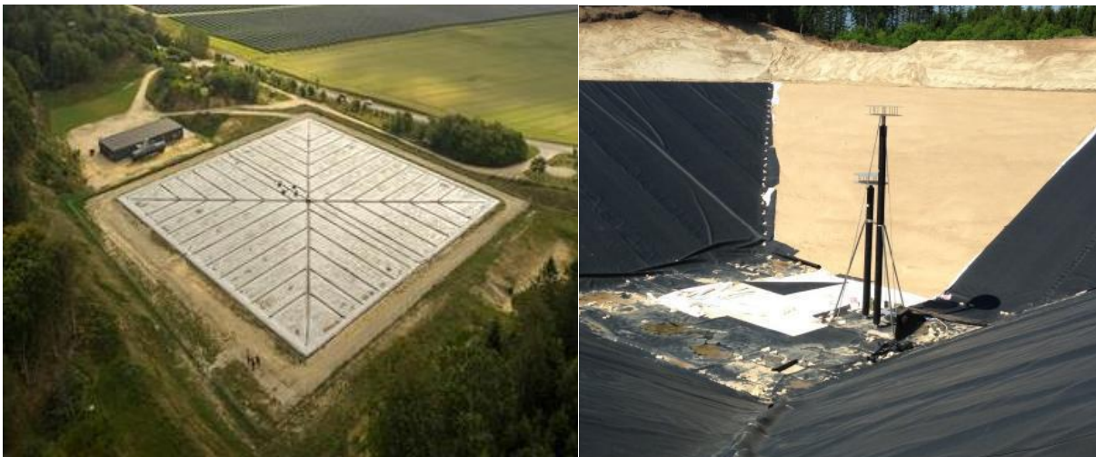
Figur 11 Eksisterende damvarmelager ved Dronninglund Fjern- Figur 12 Skråninger tættes med polymérmembran varme
