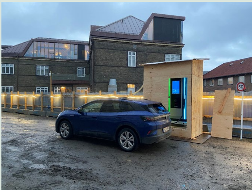
FIGUR 32. 300 kW lynlader installeret på byggepladsen.
