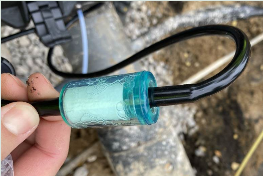
FIGUR 20. Efter et mindre antal målinger med den videreudviklede CFC-sensor gik udstyret i gastryk-alarm. Det viste sig, at filteret blev stoppet til med vand grundet meget højt vandindhold i isoleringen på fjernvarmerørene.
