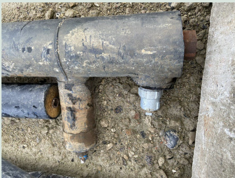
FIGUR 84. Fjernvarmerør med ventiler (M7).
