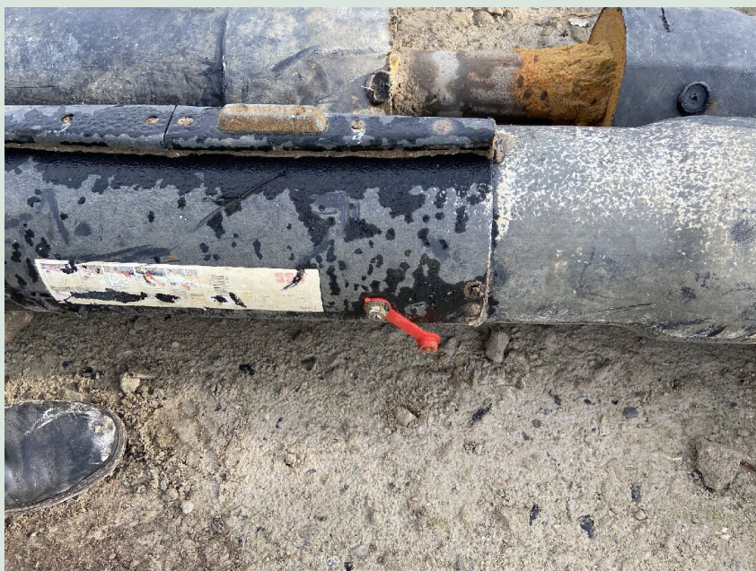
FIGUR 83. Kraftig flanche med metalprop (M6).
