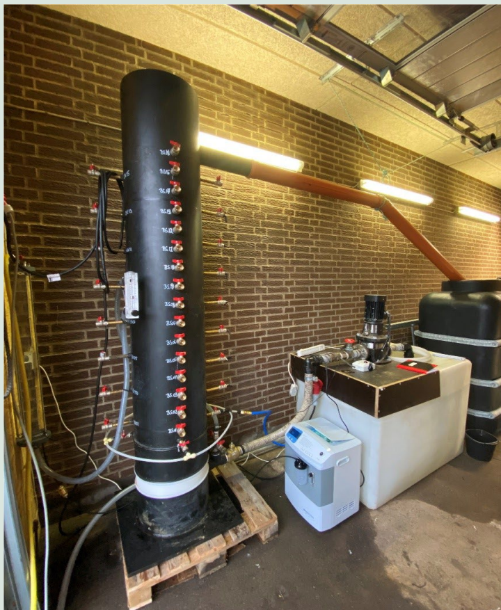
FIGUR 18. Opstilling af MethanOx Biofilteret på Tolne Vandværk. På opstillingen ses filterkolonnen med prøveudtag til både vand og sand, iltgeneratoren samt rentvandstank.
