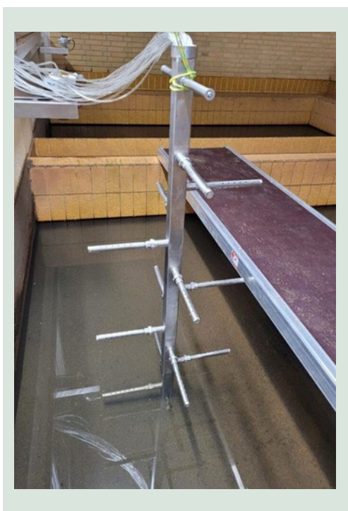
FIGUR 34. "Juletræet" placeret i et filter på Tolne Vandværk, så der kan udtages vandanalyser i filterets dybde.
