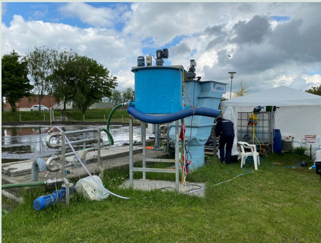
FIGUR 39. Pilotanlæg i Randers. Forrest ses et polymerindblandingsloop, herefter blandetank samt lamelseparator og bagerst i et telt en palletank med omrøring til udfældning af calciumfosfat.
