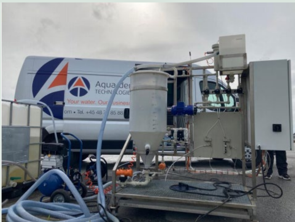
FIGUR 10. Opsætning af membran anlæg på Frederiksværk Havn.
