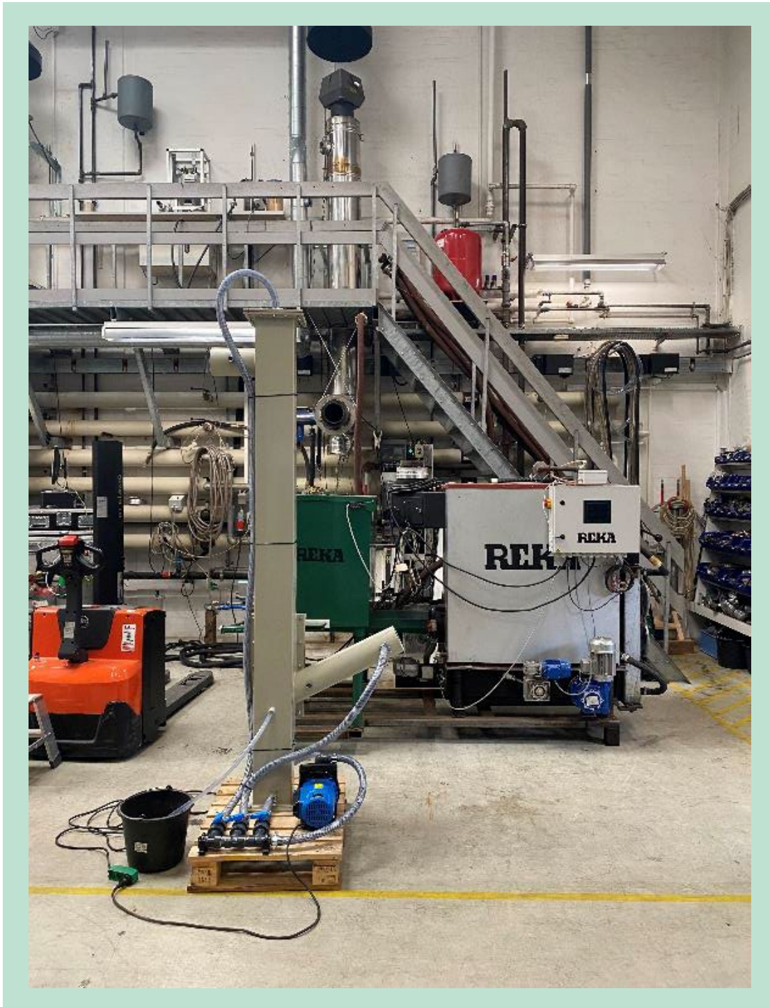
FIGUR 12. Skrubberprototype (forgrund) og kedel samt brændselssilo (baggrund) inden tilslutning.
