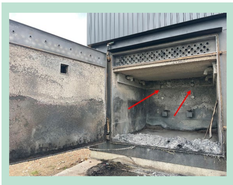
FIGUR 25. Standardkonfiguration. Sekundærluftdyser i bagvæggen er dækket.
