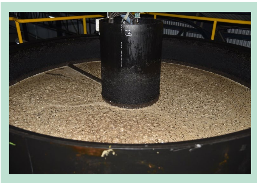
FIGUR 4. Beluftningspumpe i aerob bioreaktor. Service af pumpe kan foretages gennem det vertikale og centraliserede rør.
