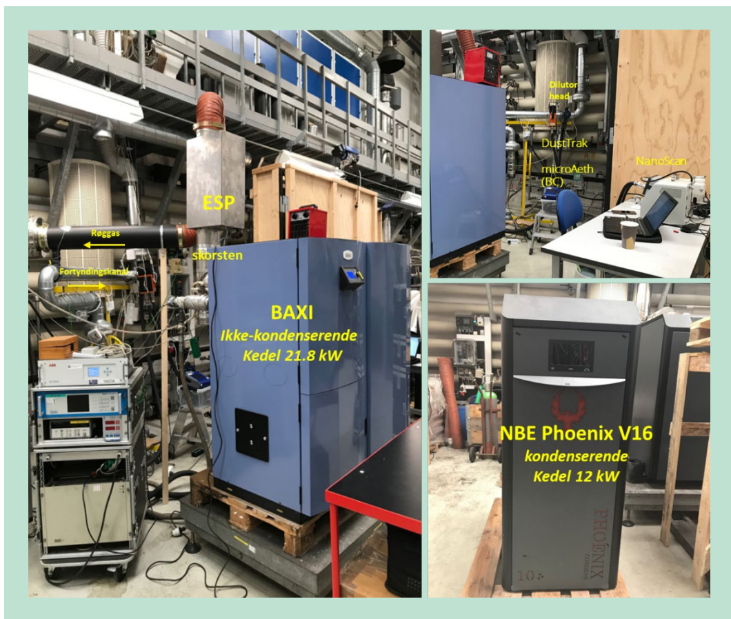
FIGUR 5. Forsøgsopstilling med ESP-filter monteret på skorsten. En mængde af røggassen ekstraheres i fortyndingskanalen, hvor røggassen blev fortyndet med baggrundsluft.
