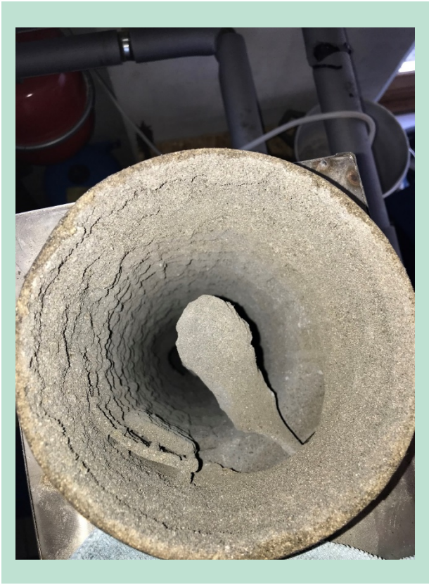
FIGUR 12. Kig ned i filtret, da det havde været slukket i en uge.
