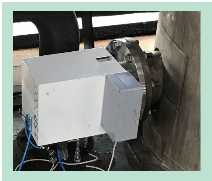
FIGUR 7. Fortyndingsprobe installeret på DFDS Crown Seaways.
