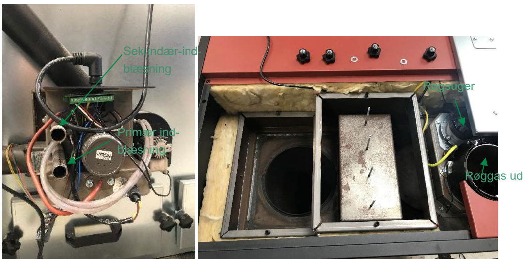
Styringsenhed til brændsel samt forbrændingsluft til de to zoner (tv). Røggasvandring igennem kedelenhed (th).
