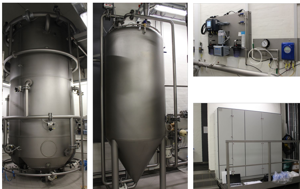
FIGUR 11. PAS-3. Fra venstre mod højre: De fire reaktorer, klaringstank, sensorpanel (øverst), automatiklavle (nederst).
