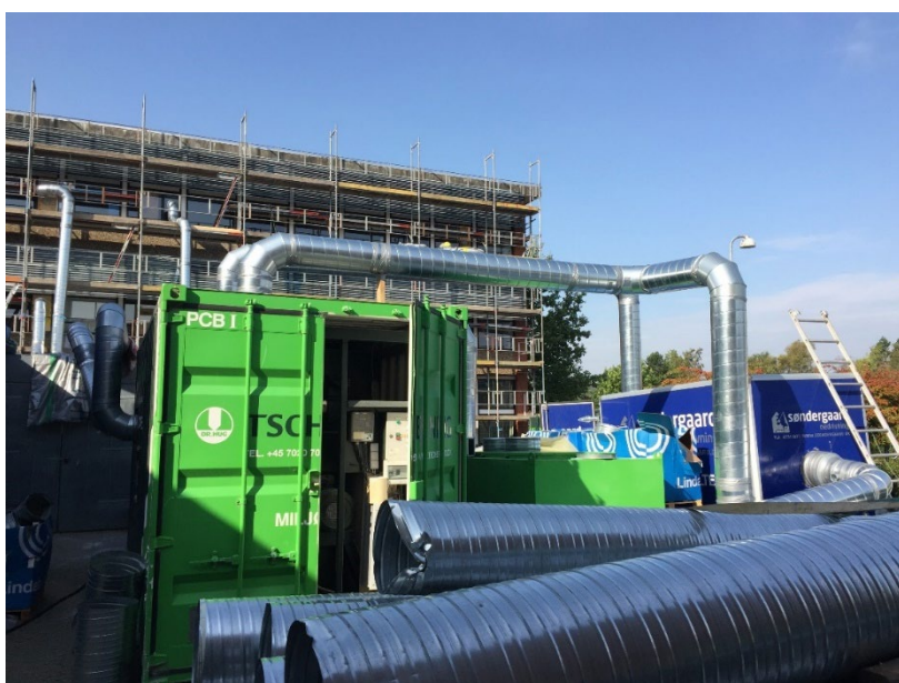
Ventilationsanlæg samt kulfiltre anvendt ved termisk oprensning af Lille Værløse Skole.
