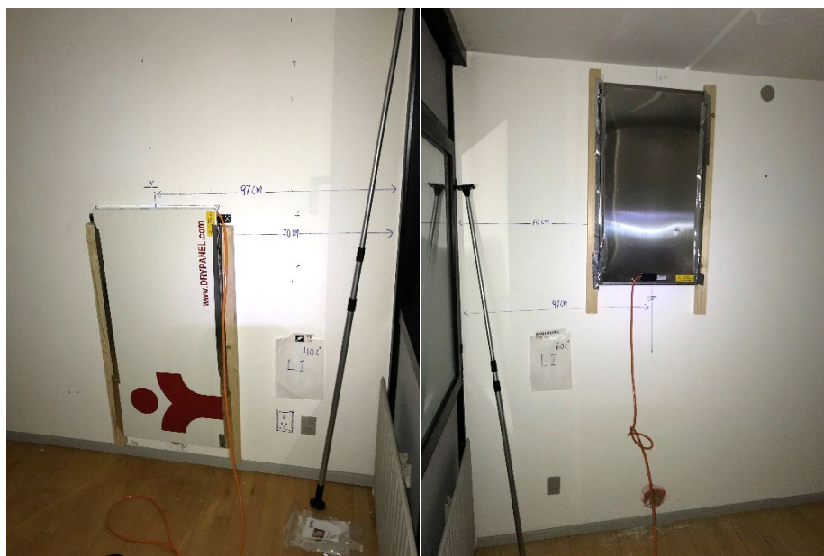
Placering af det 40 °C-kapacitet varmepanel (til venstre) og af det 60 °C-kapacitet varmepanel (til højre).
