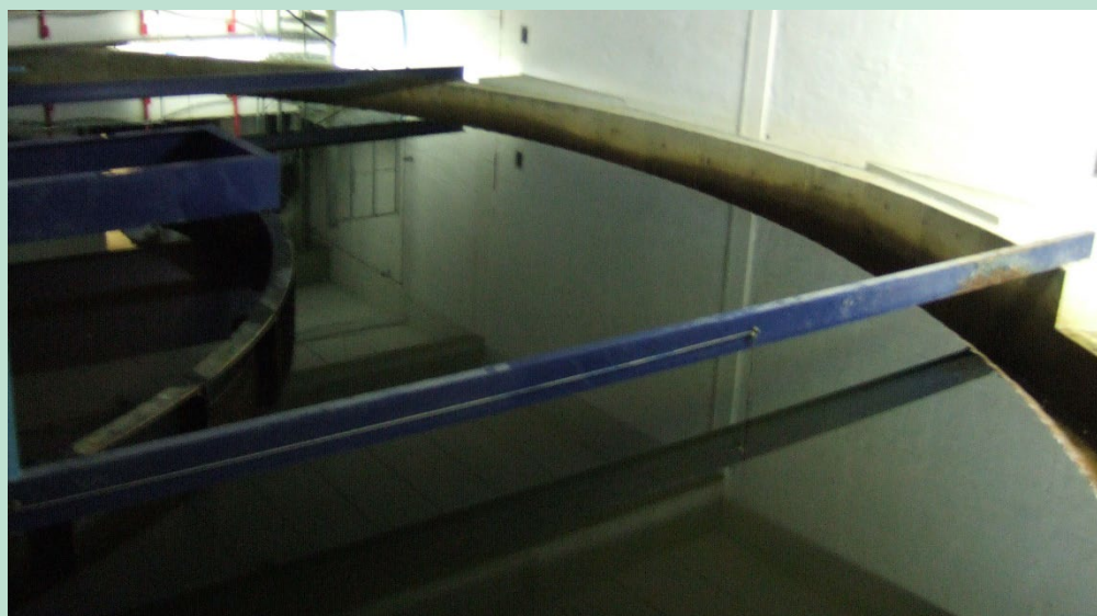
FIGUR 1. Bundfældningsbassin fra Skagen Vandværk, hvor der tilsættes jernbaseret koaguleringsmiddel.
