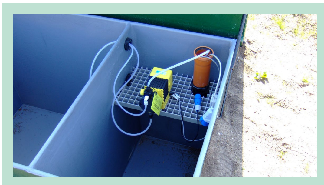
FIGUR 2. Jorddækket kemikaliebeholder og doseringsudstyr ved indløb til vådt regnvandsbassin i Silkeborg.
