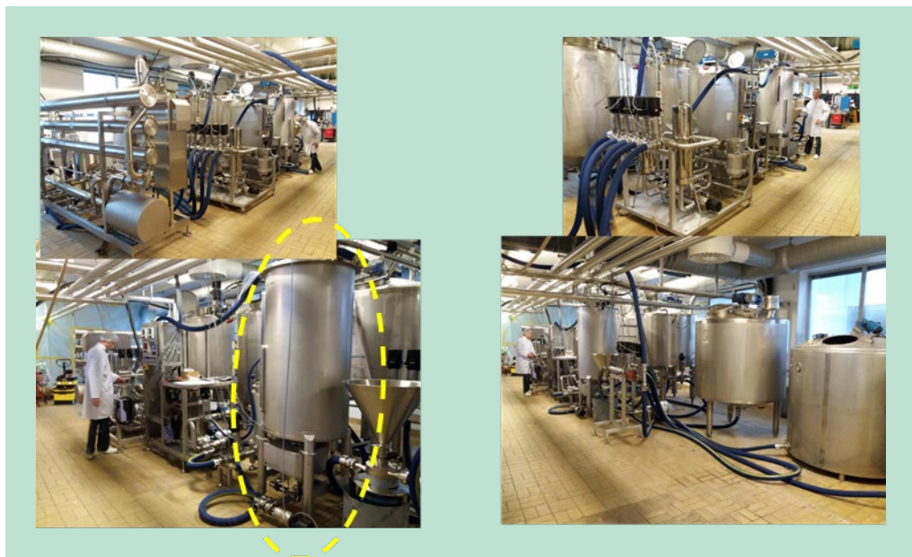
FIGUR 3. På billedet er kolonnen indrammet med gult og udgør en mindre men væsentlig del af selve installationen. I designet af denne løsning findes den adsorbent, som Up-front afsluttede udviklingen af i 2016, og som er "hjertet" i løsningen.
