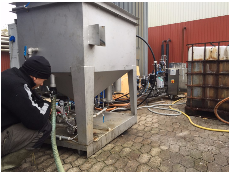
Billede 2 Flotationsanlæg. I baggrunden ses membranfiltreringsanlægget.
