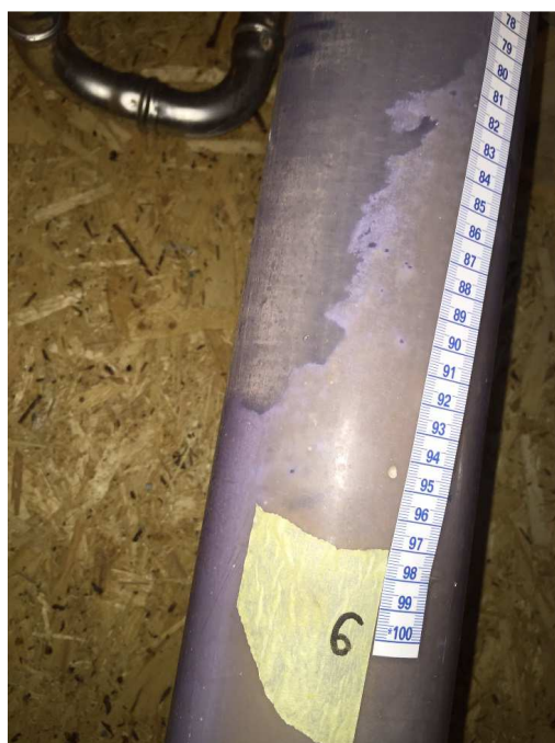
Figur 10. Kalkaflejring i pelletkolonnen
