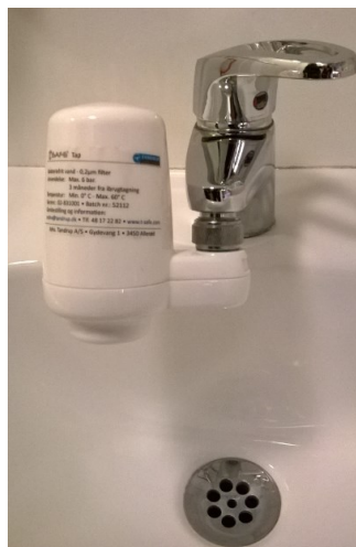
FIGUR 2-7 POU FILTER PÅ VANDHANE PÅ PATIENTTOILET PÅ HÆMATOLOGISK AFDELING PÅ HERLEV HOSPITAL
