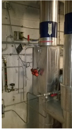
FIGUR 3-5 VARMT BEHANDLET VAND, RETUR, HVIDOVRE HOSPITAL
