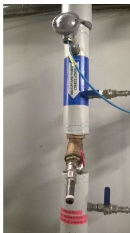
FIGUR 3-4 VARMT BRUGSVAND, CENTRAL CIRKULATIONSLEDNING VED FILTER, 50° C, HVIDOVRE HOSPITAL
