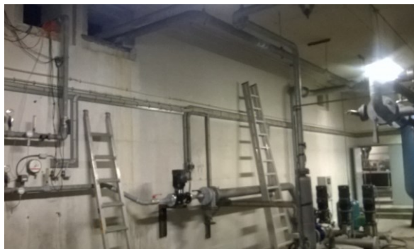
FIGUR 3-7 RESERVOIR FOR TEKNISK VAND, HVIDOVRE HOSPITAL
