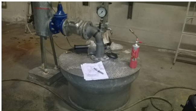
FIGUR 3-3 NØDVAND, HVIDOVRE HOSPITAL
