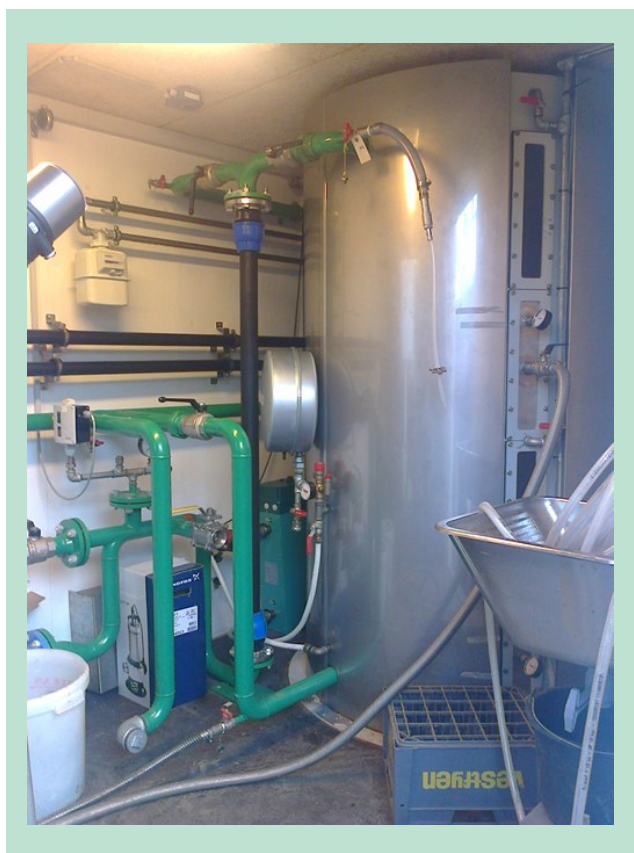
FIGUR 4. Foto af den anaerobe procestank fra containeren med forsøgsanlægget.
