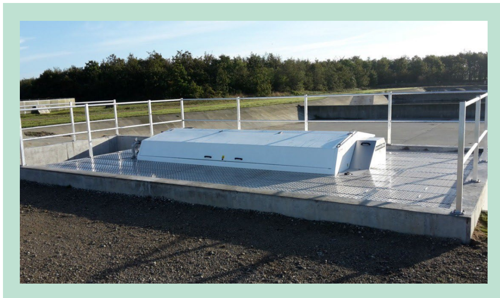
FIGUR 5. Foto af filter for efterpolering af spildevandet.
