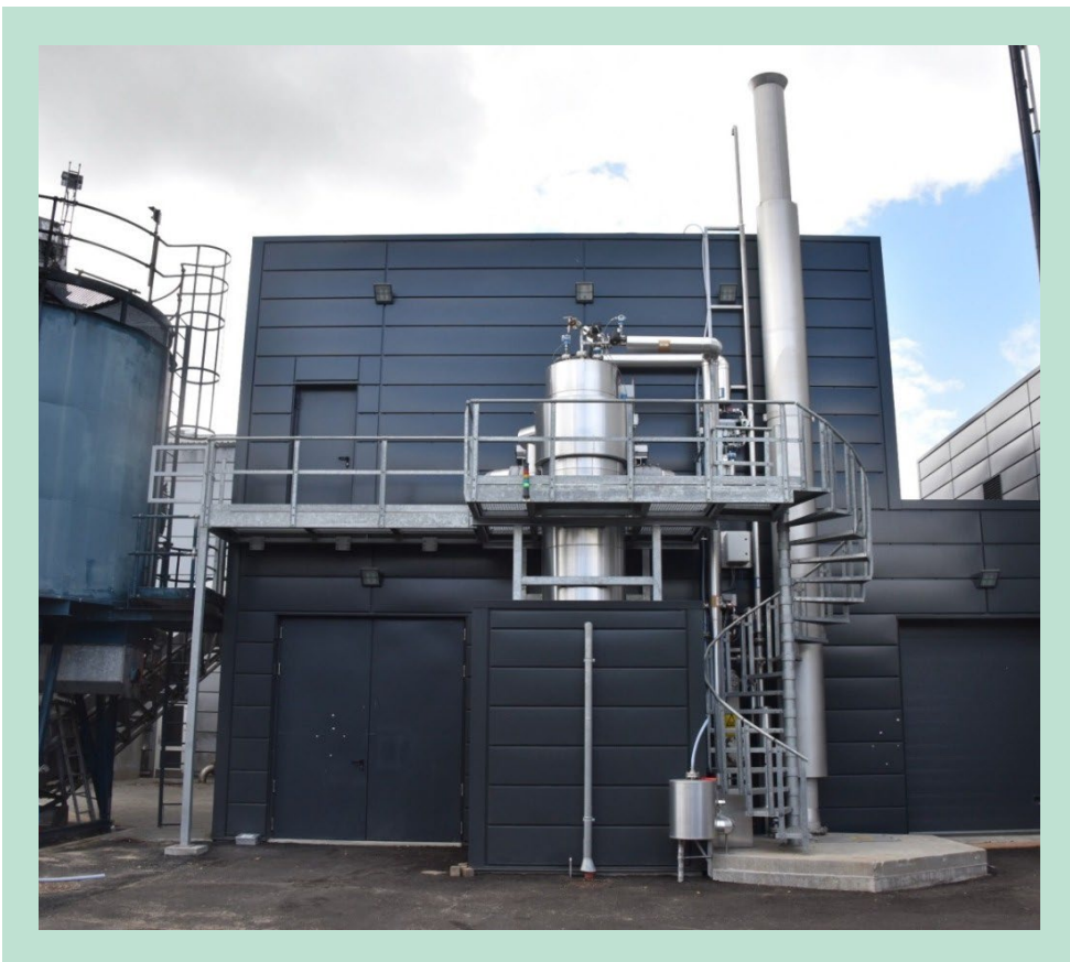
FIGUR 6. Exelys-reaktoren og den tilhørende bygning.
