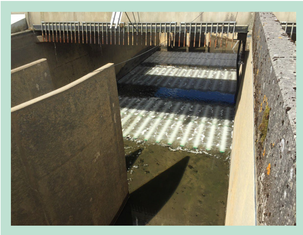
FIGUR 3. Billede af de installerede diffusorer.
