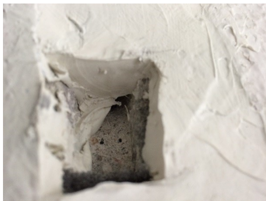
FIGUR 12: FUGEKLAT, DER INDSNÆVRER DRÆNKANALES TVÆRSNIT VED LUFTUDTAG (FOTO TAGET EFTER FJERNELSE AF STUDS TIL LUFTUDTAG).
