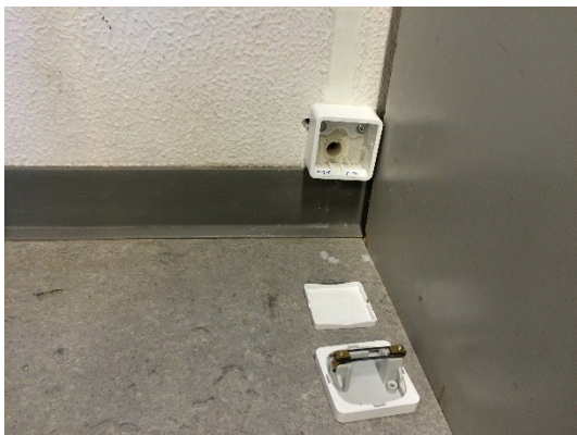
FIGUR 11: AFDÆKNING AF VENTILATIONSINDTAG I BUNDEN AF EN FUGE MED BLÆNDDÆKSEL I RAMME PÅ UNDERLAG.
