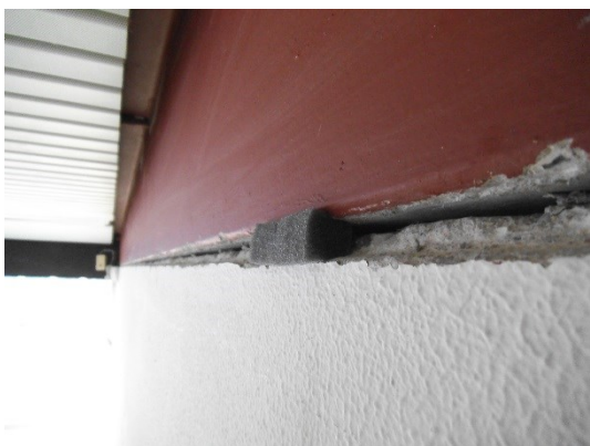
FIGUR 8: VANDRET FUGE MED MEGET LILLE TVÆRSNITSAREAL OG REVNE I BAGSIDEN AF FUGEN.
