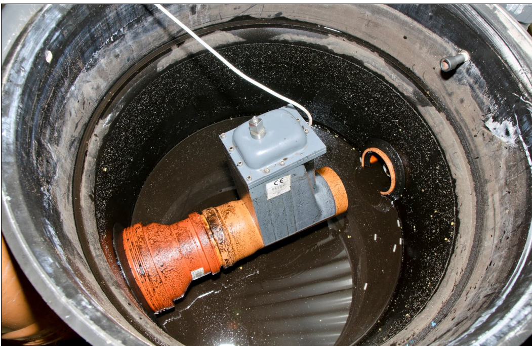
Ventil i prøvestandsbrønd
