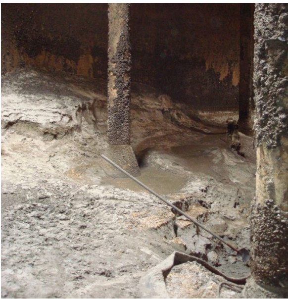
Figur 5.2 Ukontrolleret struvitudfældning i en rådnetank
