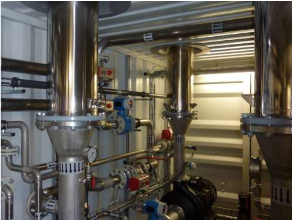
Ultrafiltreringsanlægget – den nederste del af membranrørene ses sammen med en cirkulationspumpe.
