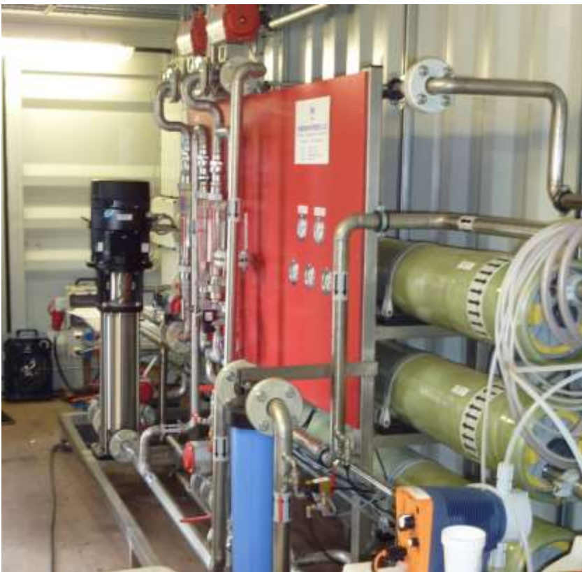
Omvendt-osmose-anlægget. Filtrene ses som gule rør til højre i billedet og derudover ses pumpen der sætter tryk - samt i forgrunden doseringspumpe for rengøringsmidler.
