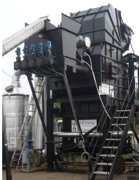
FIGUR 5 PILOT-ANLÆGGET HOS SEM STÅLINDUSTRI
