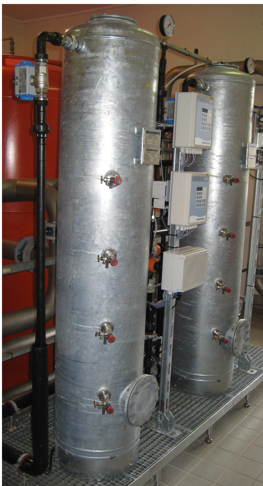
FILGUR 1 PILOTANLÆGGET PÅ VIBORG CITY VANDVÆRK
