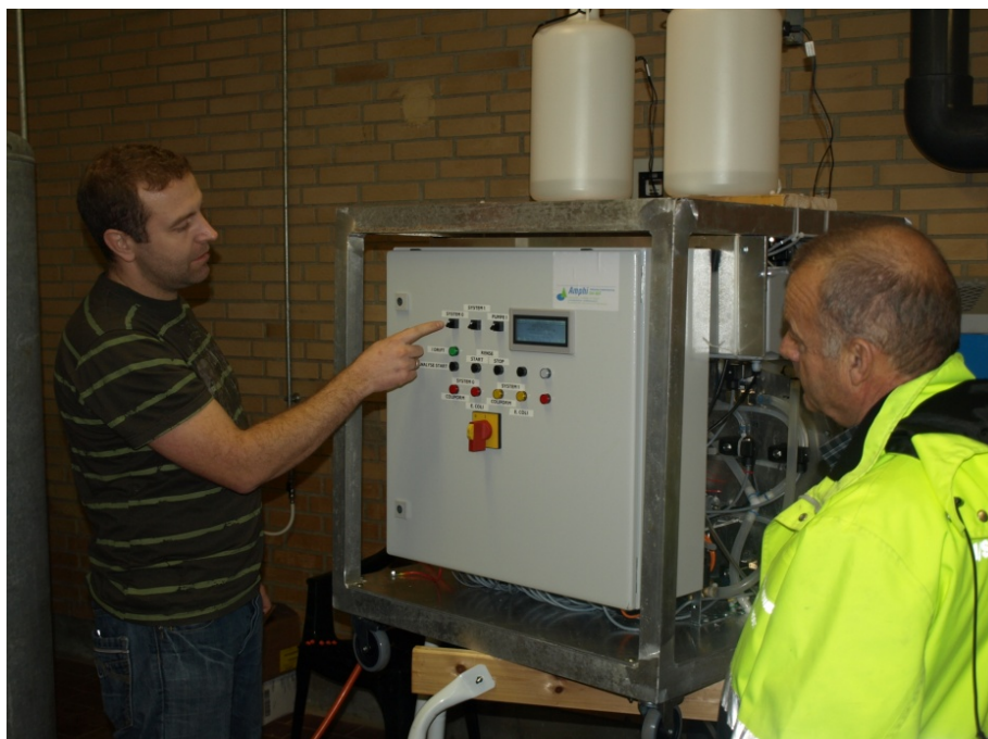
Figur 8: Billede af OCD'en opstillet på et mindre vandværk i Nordjylland.
