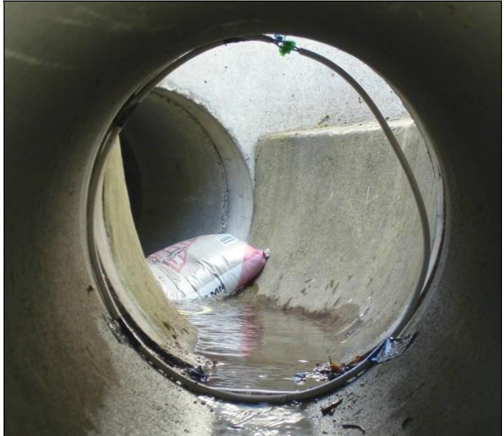
Ø500 beton med indvendig antenne
