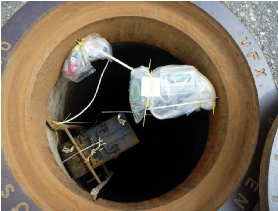
Udstyr i spildevandsbrønd. Antennen er placeret ca. 6 meter nede i brøndens bund
