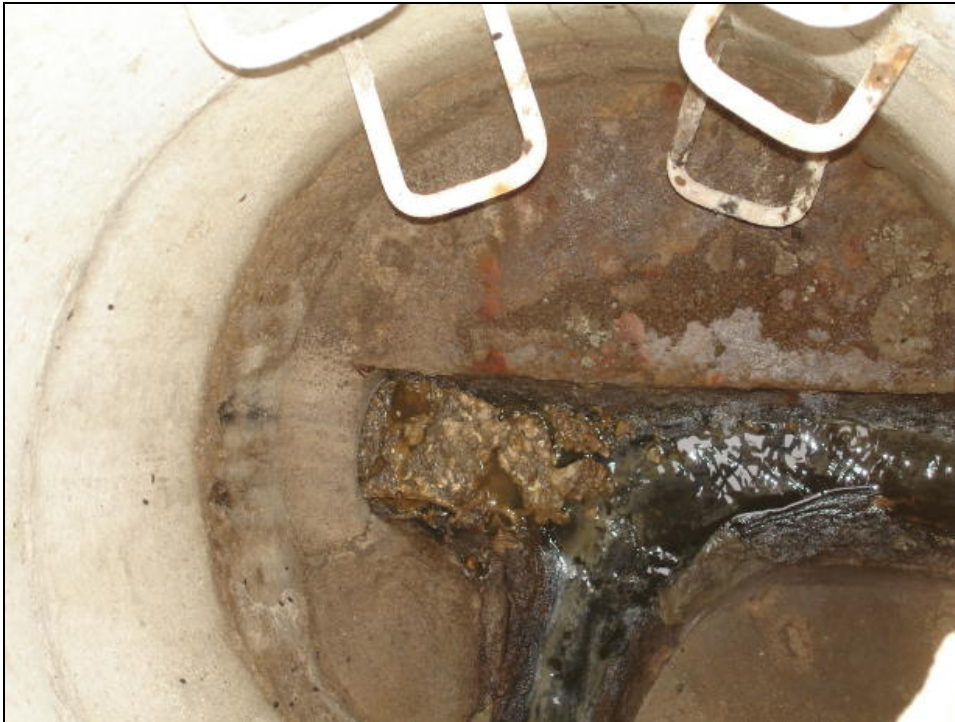
"Tilstopningskagen", ses til venstre. Kagen fangede tags opstrøms fra. Kagen blev opløst med 8-10 spande vand.
