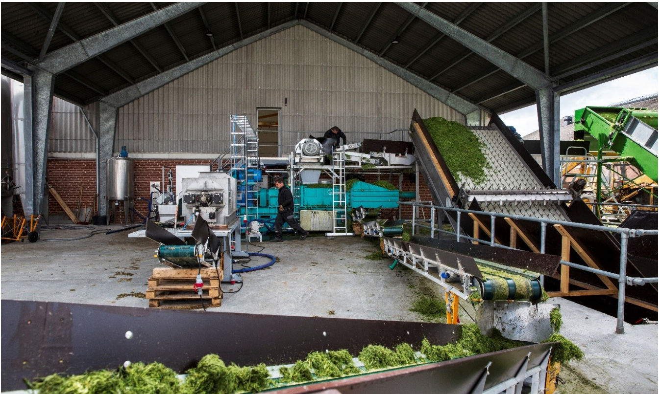
Demonstrationsanlægget set udefra.
